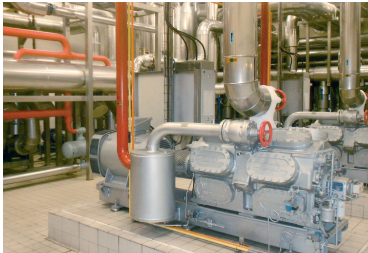
La chaleur perdue des équipements de froid est désormais récupérée.
